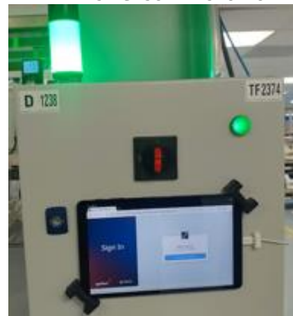
Fig. 3. Imagen de referencia de sistema ANDON instalado en EMPRESA CASO DE ESTUDIO
