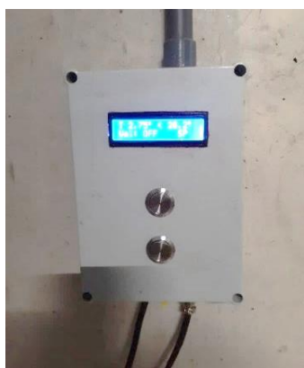
Fig. 4. Enoc: Controlador de temperatura de tanques de fermentación.
